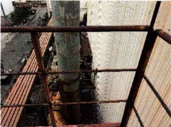
图 25 熔铸 3#除碱工序排气筒
