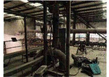
图 21 3#立式喷涂生产线固化炉
