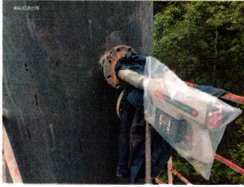
图 16 铝渣回收工序排气筒
