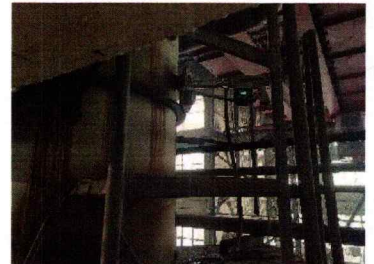
图 24 熔铸 1#、2#除碱工序排气筒
