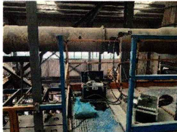
图 23 3#立式喷涂酸雾废气排气筒
